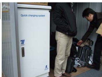
充電施設 (直流電源部)
