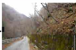
災害時に崩落の恐れのある箇所
