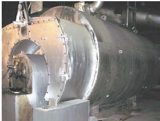
ボイラーの保温材
