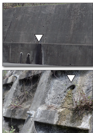
地下水の流出
